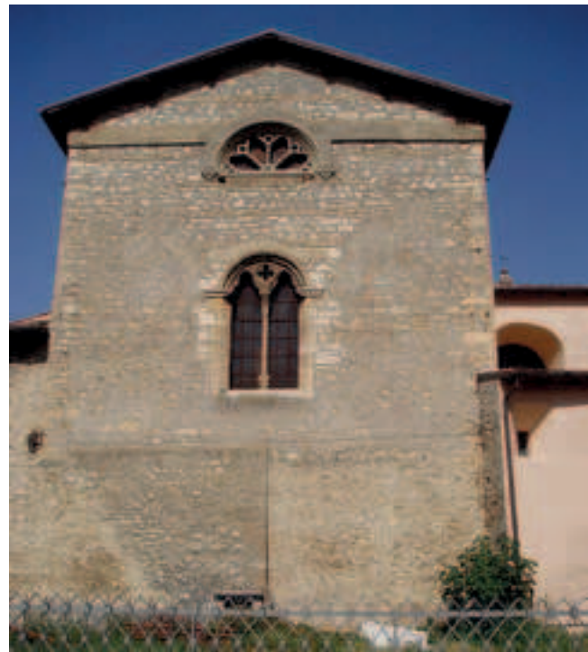
Fig. 12 - Esterno della basilica: nel fronte presbiteriale sono chiaramente visibili la muratura listata e il cordolo in cemento armato realizzati con il restauro degli anni 1920-25 (foto dell'autrice)
